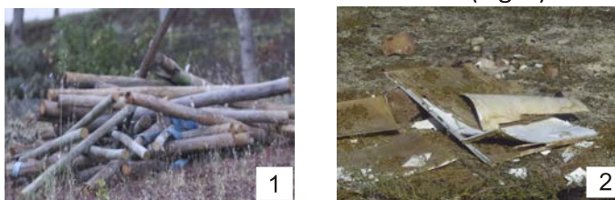
Atrayentes de termitas subterráneas. Troncos y maderas en contacto con el suelo y abandono de restos de madera.
